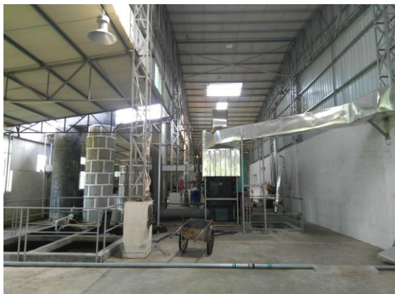
锅炉处理设施
